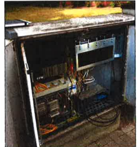
Die beengten Platzverhältnisse und großen Temperaturunterschiede im KVz stellen hohe Anforderungen an die installierten Switches
